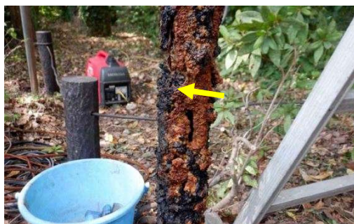
（腐蝕した管に穴が開いている）
